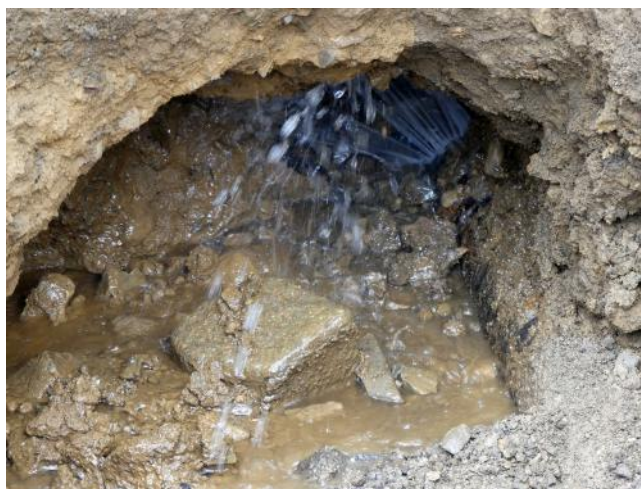
La rupture de la canalisation est bien visible
